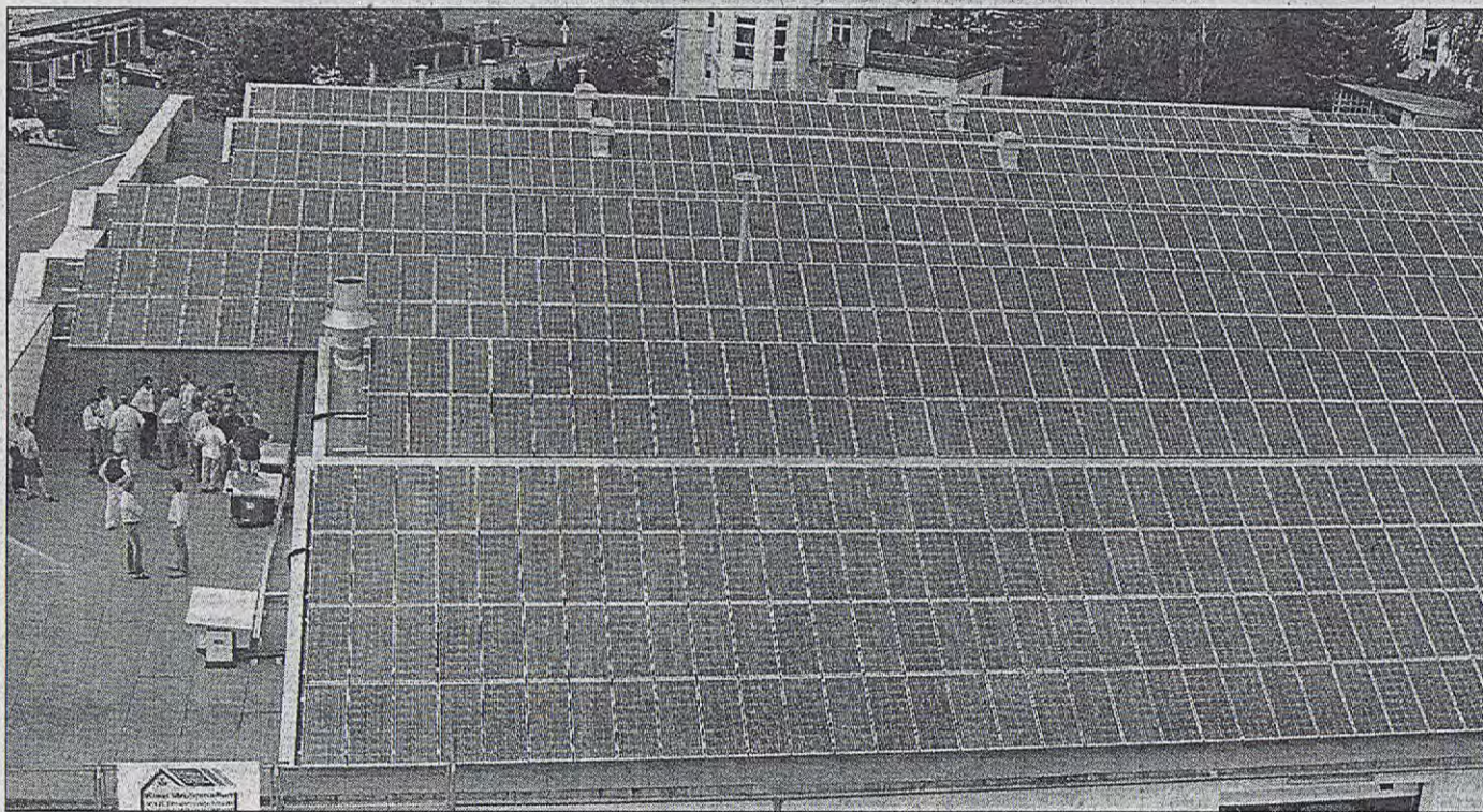
Exkursion auf dem Dach: Wechselrichter und Solarzellen konnte man sich gestern aus direkter Nähe betrachten FOTO: -rai
