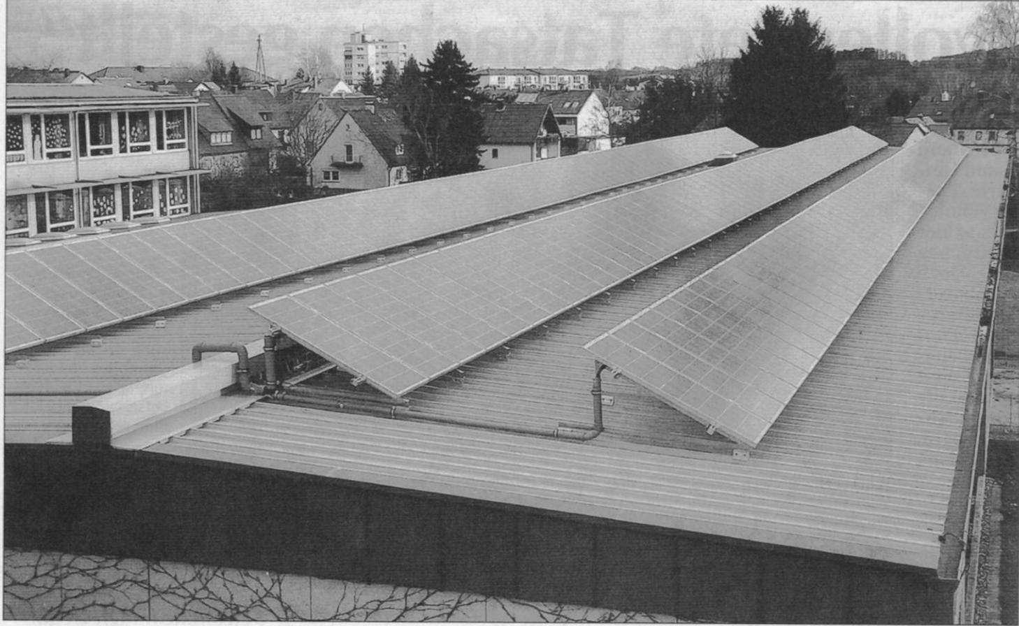
Noch ist es ein ungewohntes Bild: In drei Reihen mit je 66 Modulen präsentiert sich die Photovoltaikanlage auf dem Dach der Volksschule. Die Gesamtfläche beträgt 182 Quadratmeter. (dih) Bild: dih
